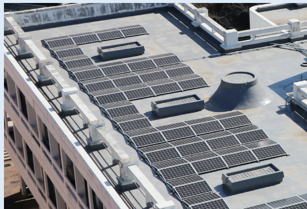
3号館屋上（パネルは東西向き傾斜10度）
