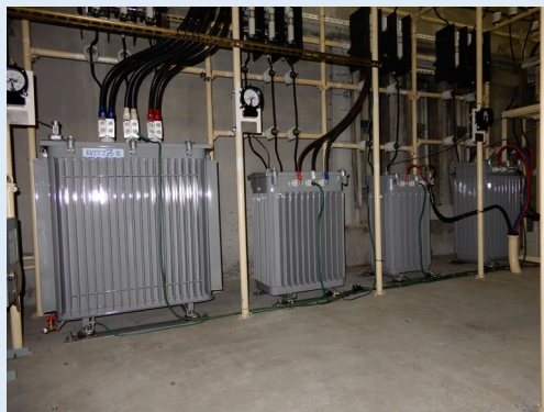
2号館電気室変圧器（4台一斉更新）
