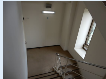
本館 階段誘導灯（25WかLED13Wへ） 段階調光付LED照明
