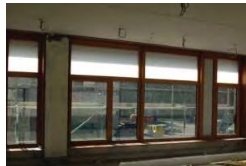
窓に取り付けているブラインドコントロール
