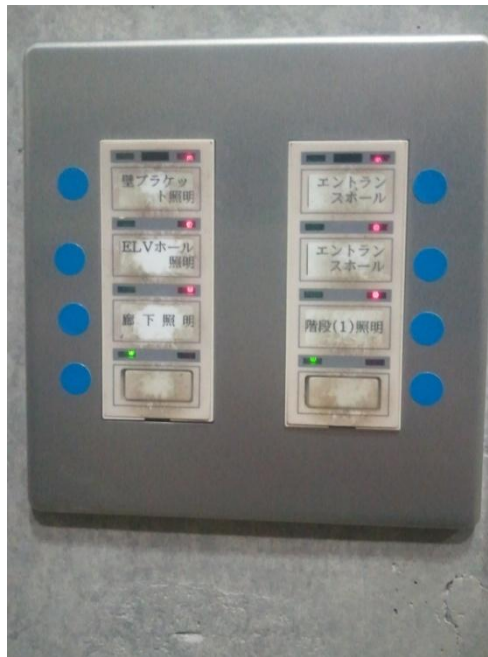
図 3-2-4(3). 在室ランプ周辺の照明スイッチ
